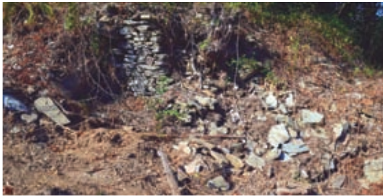
Aspecto dos danos causados na zona do castelo de Penaflo
