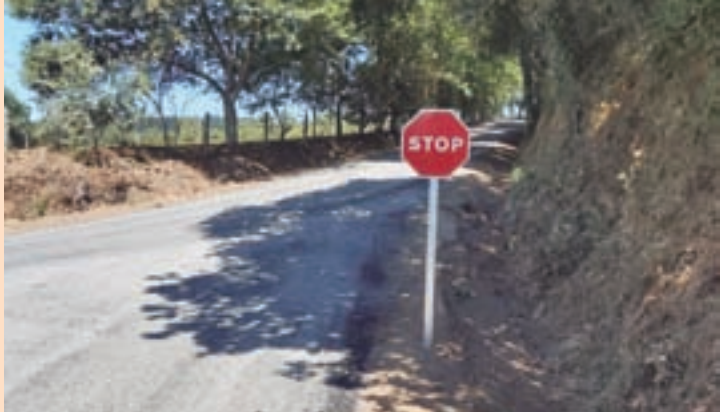
Unha imaxe do estado no que quedaron as obras
