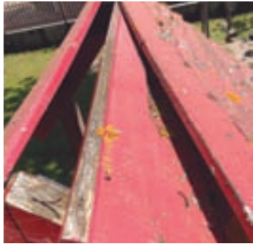
Unha das pezas en mal estado
