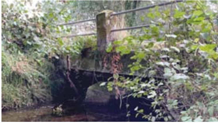
Estado no que se atopa a ponte da Ribeira
